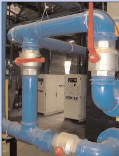
Fig. 3 – Rede de ar comprimido.
